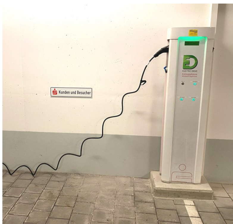
E-Ladesäule in der Tiefgarage Miesbach der Kreissparkasse Foto: Sparkasse
